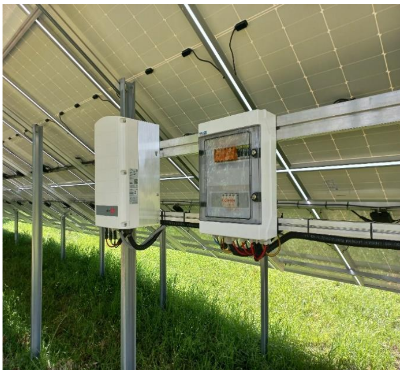
Fot. Szafy z aparaturą sterującą i przetwarzającą energię z poszczególnych paneli
