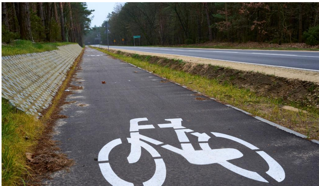
Fot. Droga powiatowa nr 3635W w m. Przywory Duże – II etap (nowa nawierzchnia jezdni, droga dla pieszych, droga dla rowerów, odwodnienie – kanalizacja deszczowa, rowy)
